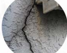
外壁ひび割れ
